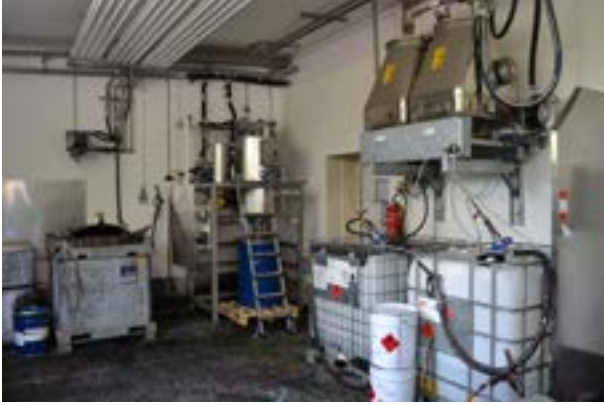
JG Service firmasındaki Solvent Arıtma Tesisli ASC-150 24 kW (Kaynak: OFRU)
